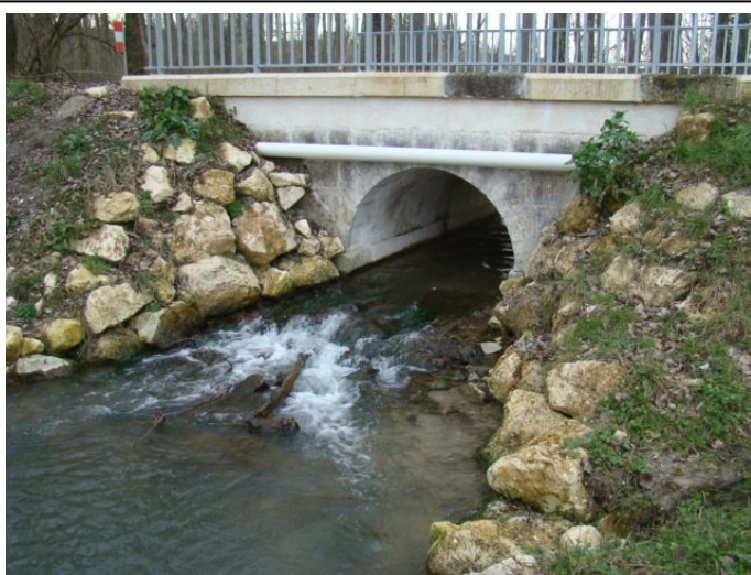
Avant travaux : chute aval du pont en 2015
