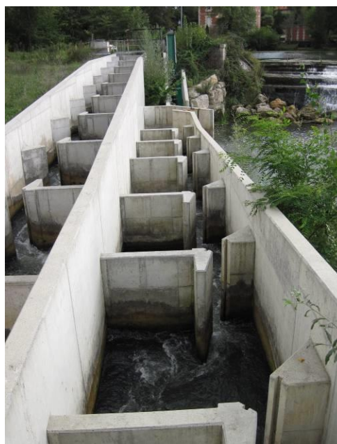
Fig. 3 : Passe à bassin (premier plan) et rampe à brosse (second plan) de Monfourat
