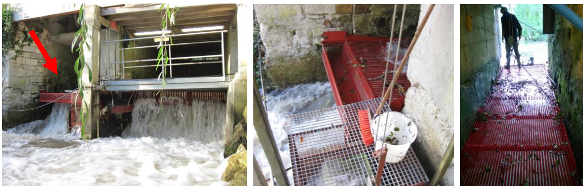
Fig. 22 : Equipement du pertuis de décharge
