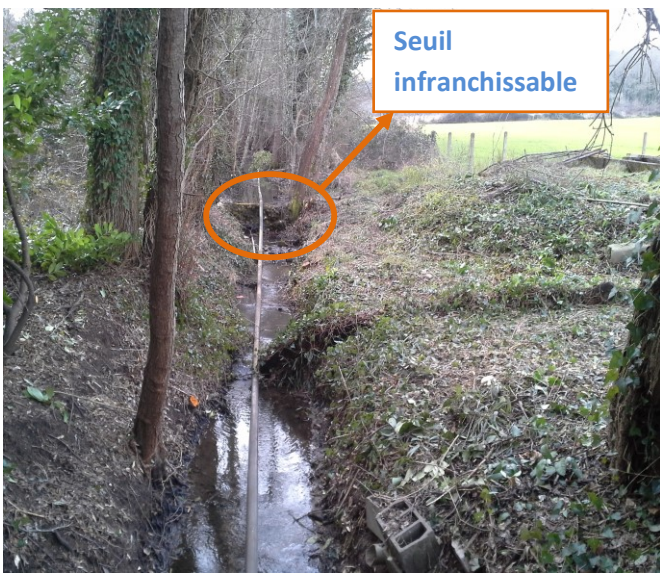
Avant Travaux : Aval du seuil avec rupture de pente
