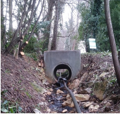
Buse infranchissable et sous-cavée
