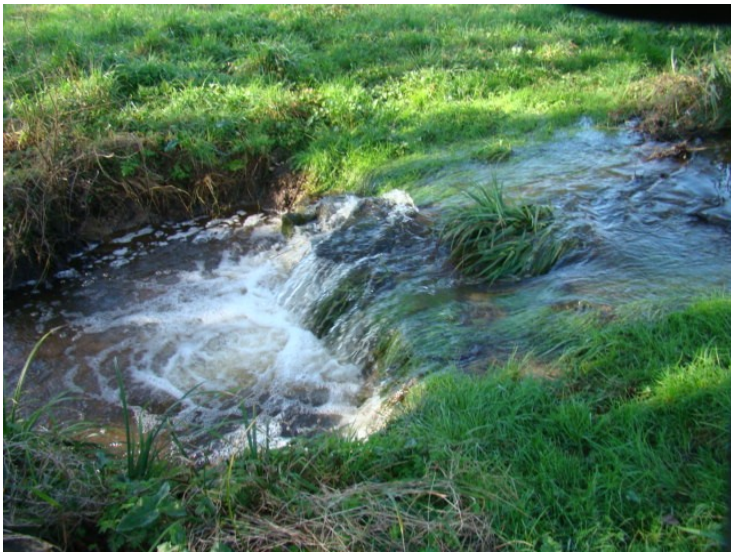
Avant Travaux : Chute formée par une buse mal calée transformée en gué 2014
