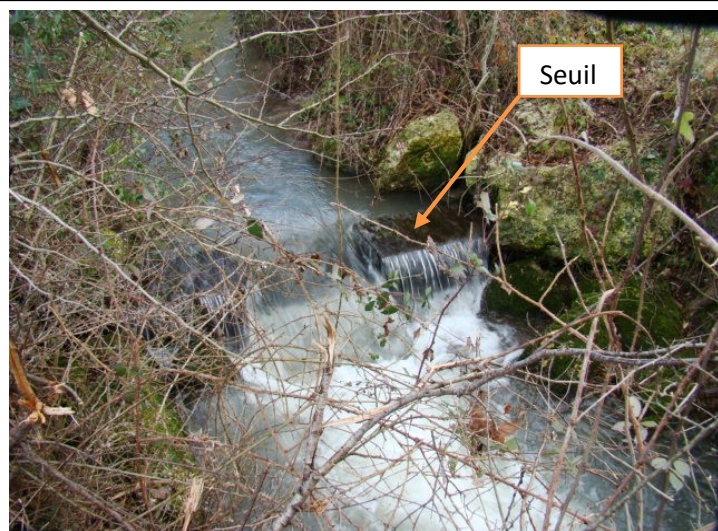
Avant Travaux : Seuil Infranchissable
