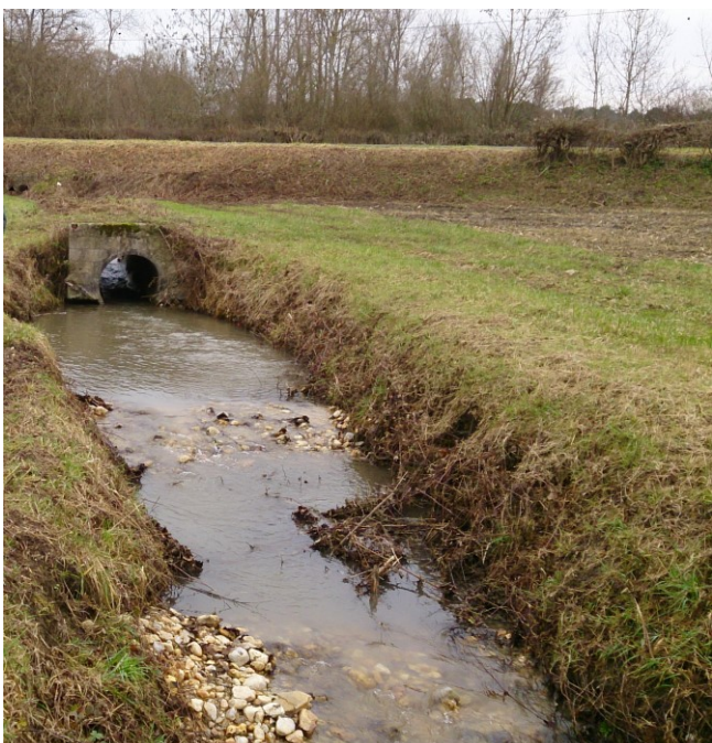
Buse 2 : Après travaux après une crue
