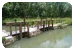
Vanne de décharge (4)
