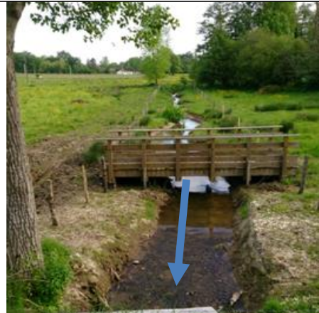
Après travaux vue amont du pont et déplacement de la passerelle à bovins
