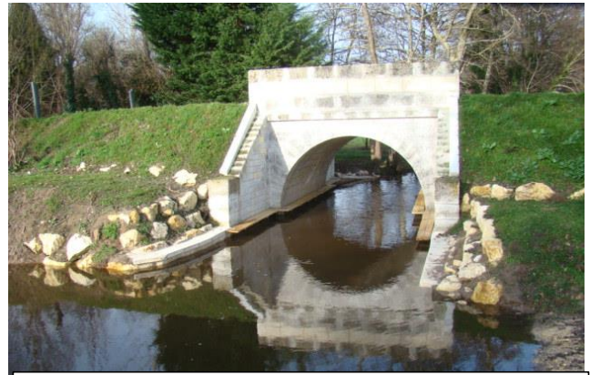
Après travaux vue par l'aval du pont. Maçonneries restaurées par le CG 16 avec pose de passages à visons
