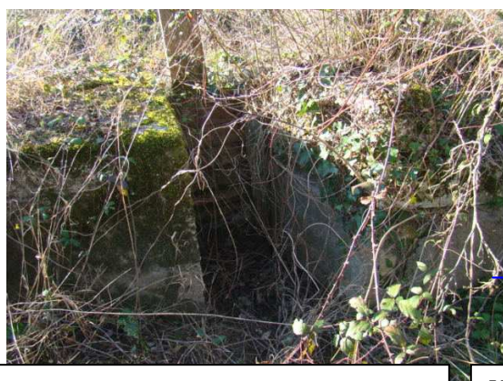
Ouvrage vétuste de décharge amont
